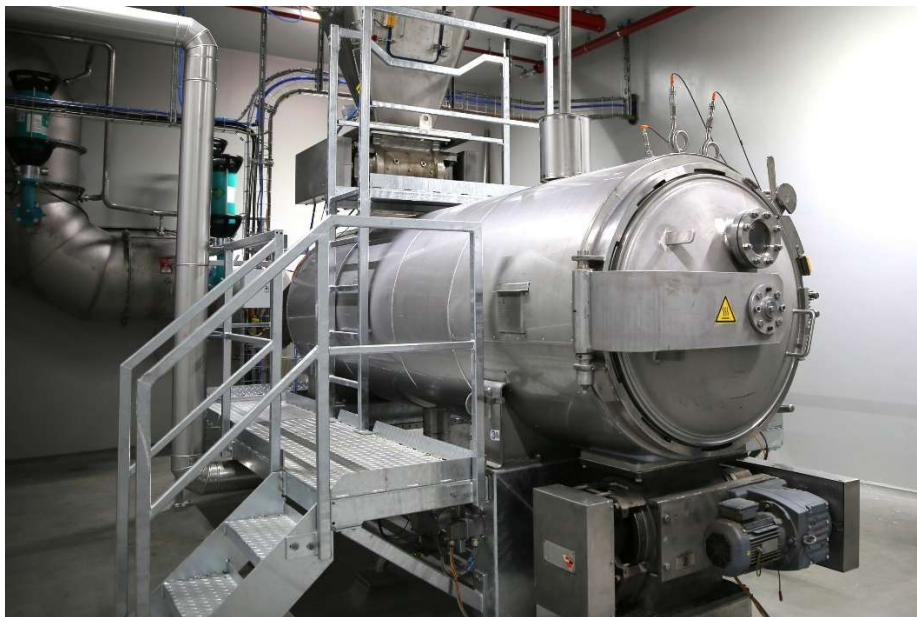
Die neue Keimreduzierung ist die erste Anlage, die in der sanierten Produktionshalle 12 den Betrieb aufnimmt.
