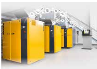
Abbildung 2: In der Station selbst kommunizieren die einzelnen Komponenten zur Druckluftherzeugung mit der übergeordneten Steuerung.
