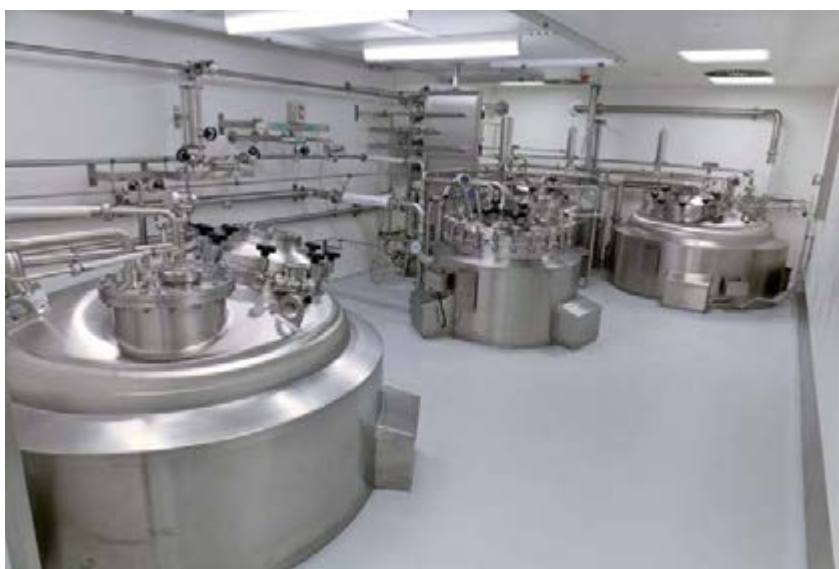
Abbildung 3: Ansatzbereich, aus Übersichtsgründen ohne Laminar-Air-Flow(LAF)-Vorhänge vor Abschluss der Endmontage (Quelle: Plantech Engineering).
