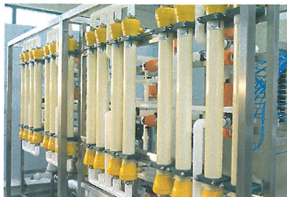
Abb. 4: Ultrafiltrationsanlage, 14 m 3 /h HPW.
